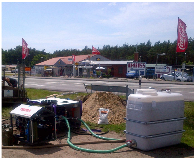
Le groupe hydraulique avec la station de mélange et d'injection et la cuve de 1'100 litres sont positionnés à côté de la fouille de travail.
