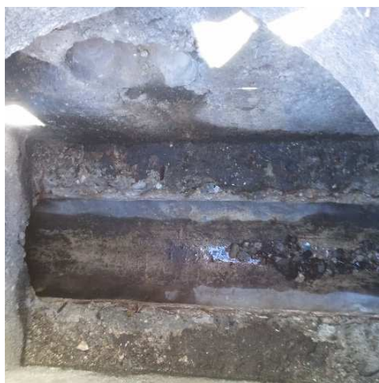
Vue de l'ancien tuyau dans le regard.
